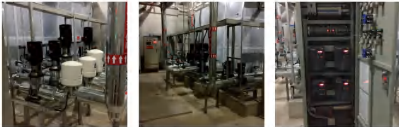
大连供暖供水
