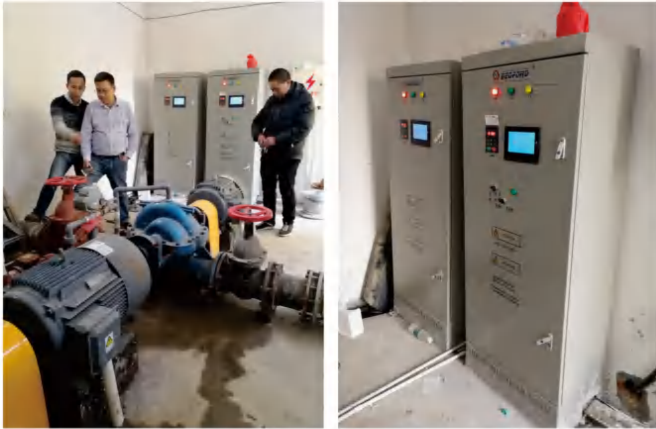
玉环楚门河道2号泵站
