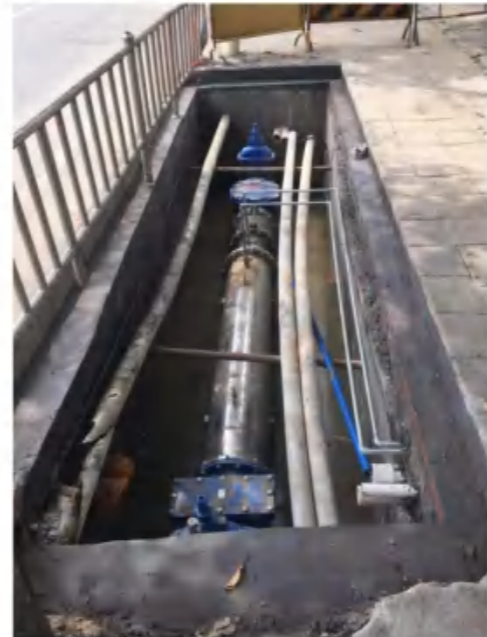
增城新和自来水有限公司中途加压静音管中泵系统
