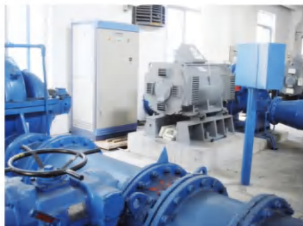
石溪水厂 应用280kW
