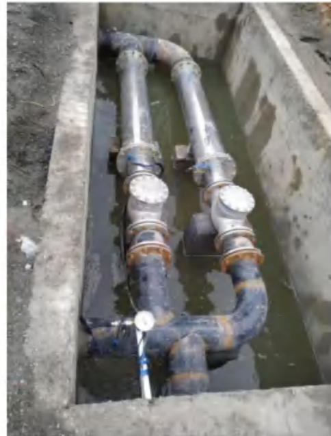
华南师范大学静音管中泵加压系统
