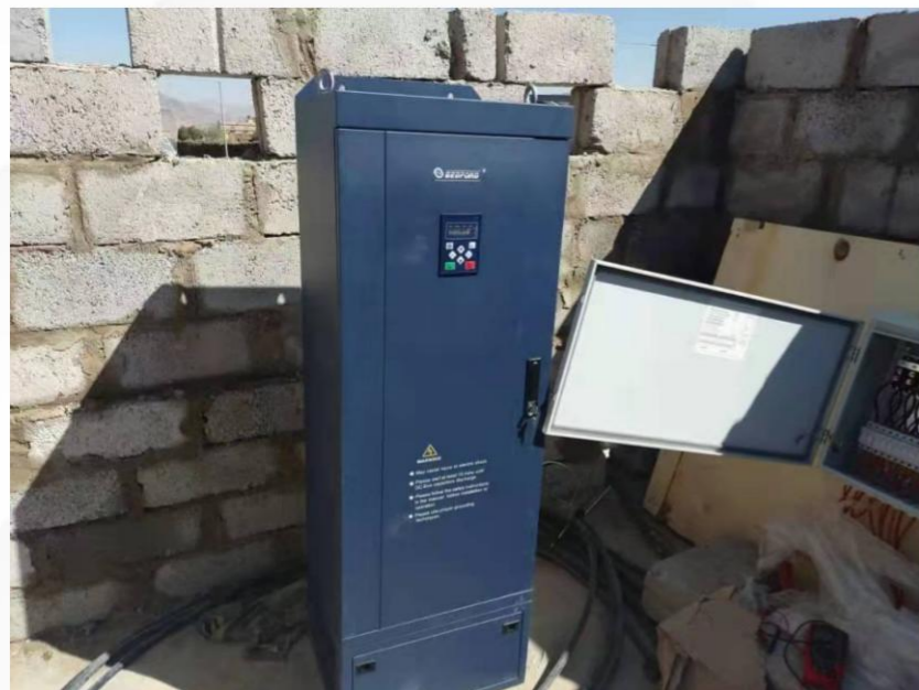
132kW 太阳能抽水系统应用
